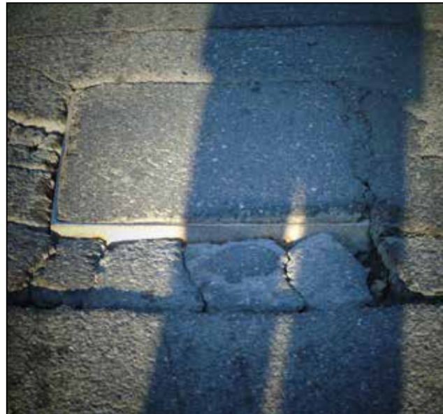
La rotonda di via Levadello ha un pericoloso dissesto
