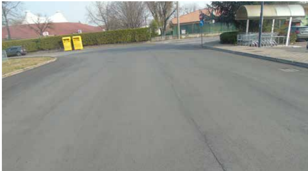
Manca la segnaletica tra via Tasso e via Attiraglio
