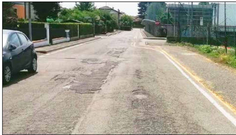
TRAVAGLIATO: via Mazzini è una strada tutta a toppe
