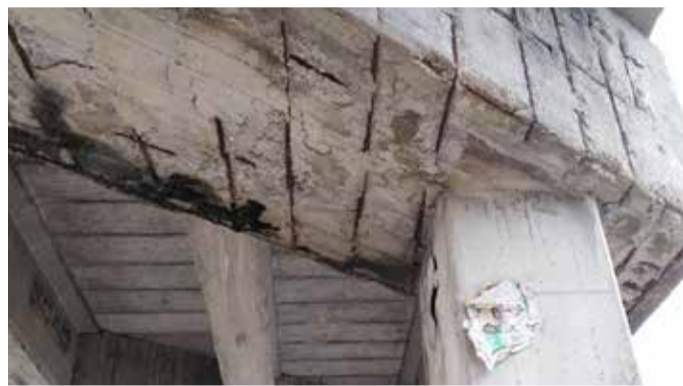
Le condizioni del cavalcavia Moro destavano preoccupazioni tali da aver indotto l'Amministrazione comunale a chiuderlo
