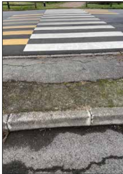
TRAVAGLIATO: via Brescia. Barriere architettoniche al passaggio pedonale
